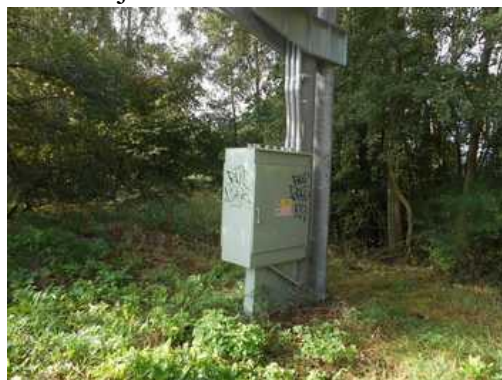
věcné břemeno - trafo
